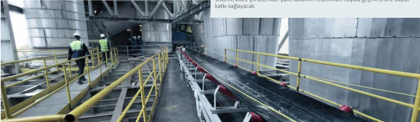
Niğde Tesisi Atık Besleme Sistemi
