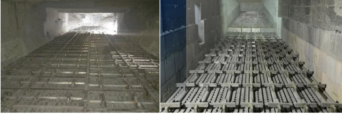
Şekil 7. DF#1 için planlanan soğutucu modernizasyonu (öncesi ve sonrası) gösterimi
